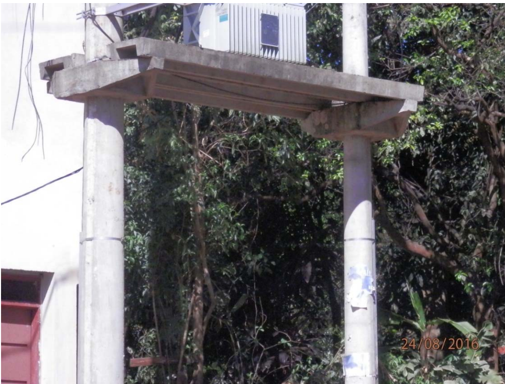
Subestación transformadora pasante para línea desnuda AL puro , en la periferia de la columna se observa las bajadas de toma tierra con su protección mecánica sunchada a la columna, por encima del transformador el tablero de protección y alumbrado público, sobre la cruceta de H º A º están los seccionadores fusibles bajo carga y los descargadores atmosférico
