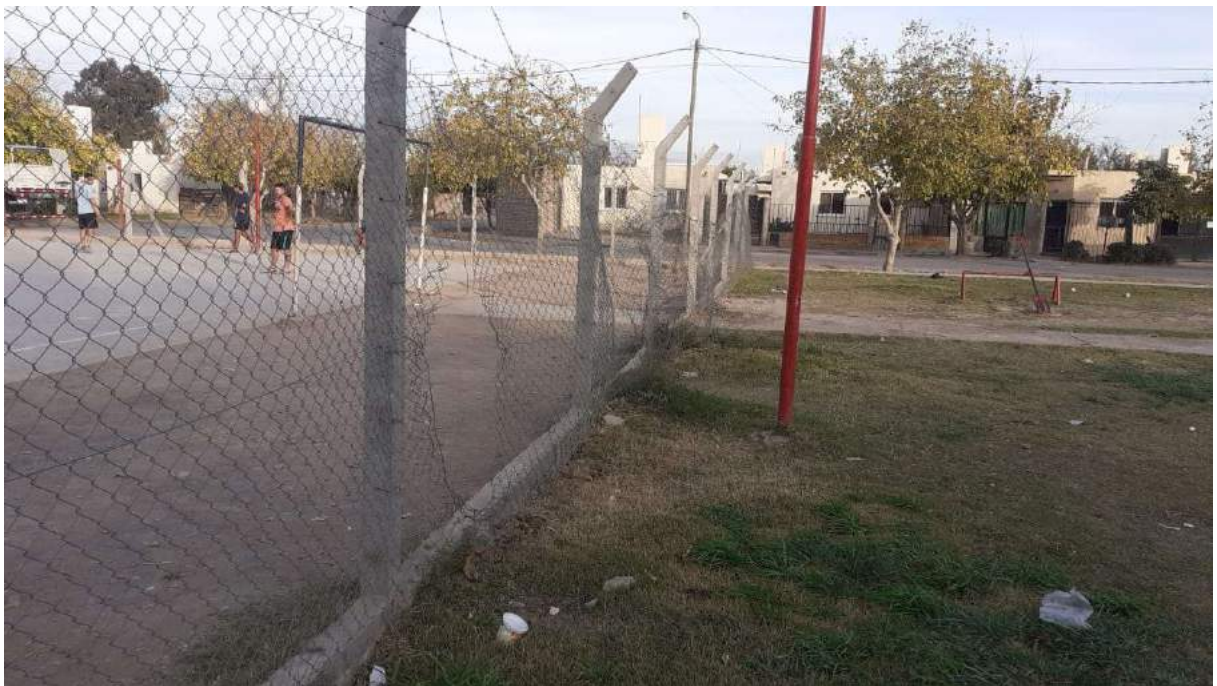
Vista de la plaza 1 del Barrio Sierra Morada en la cual se encuentra el playón deportivo de uso barrial, donde se observa el deterioro del cierre perimetral del playón y el uso del mismo.
