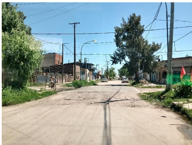
Foto 05: Intersección entre calles Aguado y Magallanes. Falta finalización de pavimento y cordón cuneta en esquinas.
