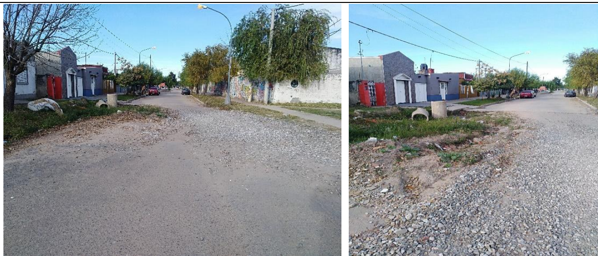
Fotos 06 y 07: Intersección calle Aguado y Callejón Borges, falta finalización de obra de pavimento y cordón cuneta.
